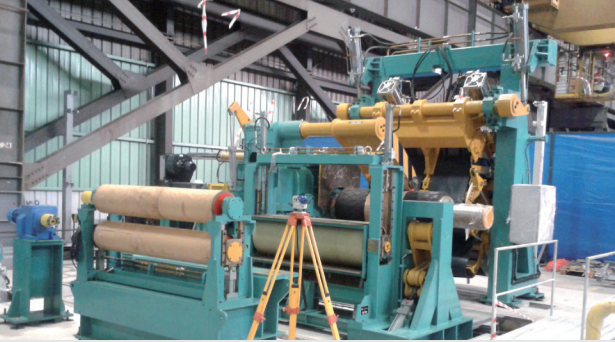
Tension Leveller Hattı Kurulumu
